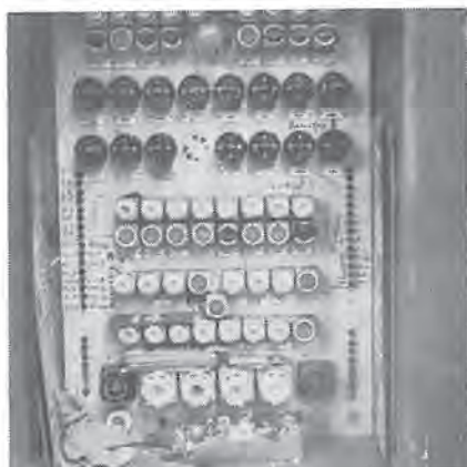
Sicherungsverteilung aus Marmor Bedienungsseite
