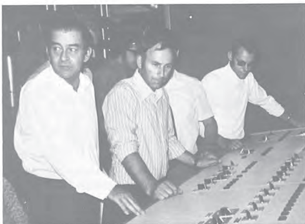
Herr Melliger demonstriert das Kommandopult der Heizung und Warmwasser-Aufbereitung
