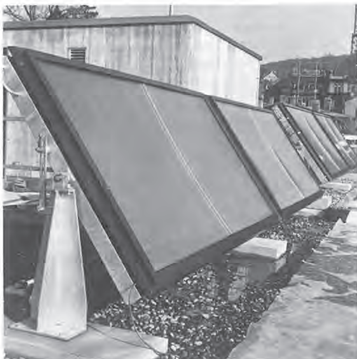
Die Sonnenkollektoren auf dem Dach unseres Bürohauses heizen einen Wasserkreislauf, der über einen Wärmeaustauscher das Brauchwasser für Kantine, Waschbecken und Sauna erwärmt.
