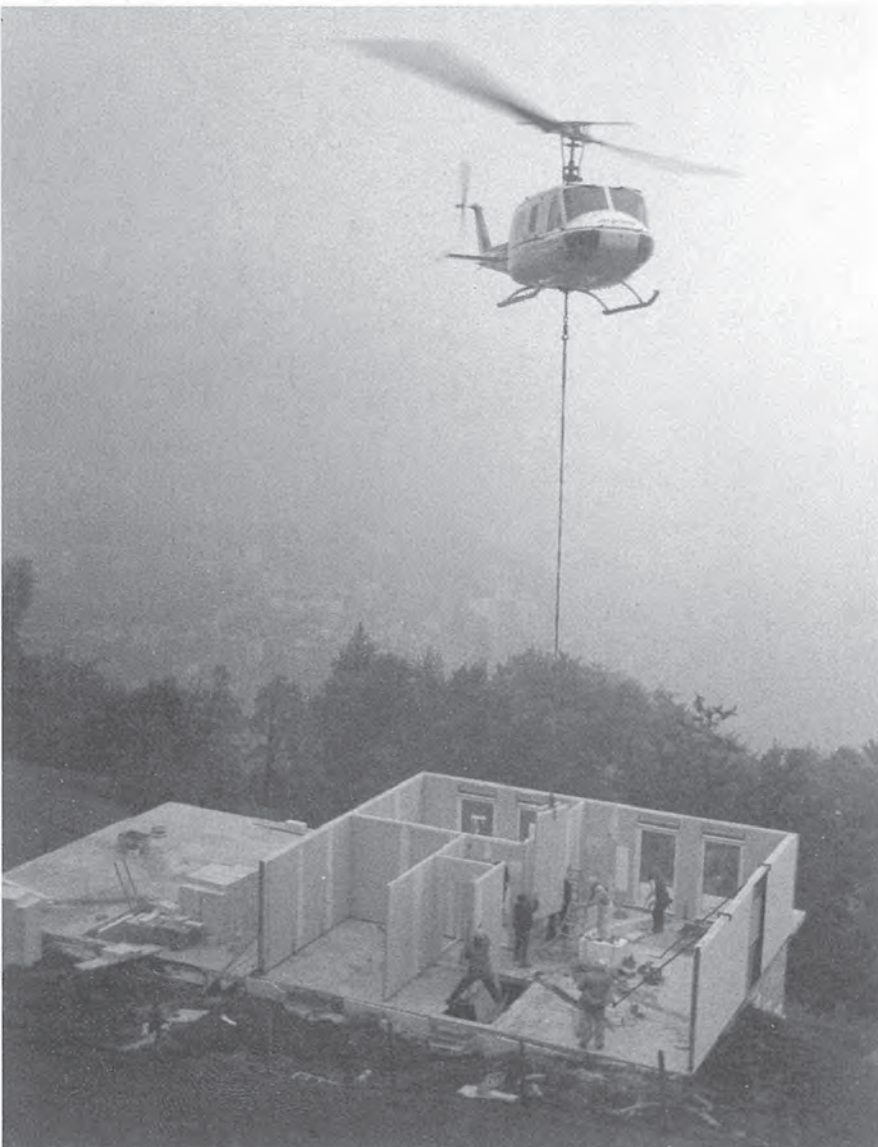
Wie man sieht, ist bei Fertighäusern fast alles möglich: Dieses Haus wurde in Rigi-Schwanden oberhalb Vitznau aufgebaut. Die Baustelle war nur durch einen Fussweg erreichbar, deshalb musste ein Helikopter eingesetzt werden.
