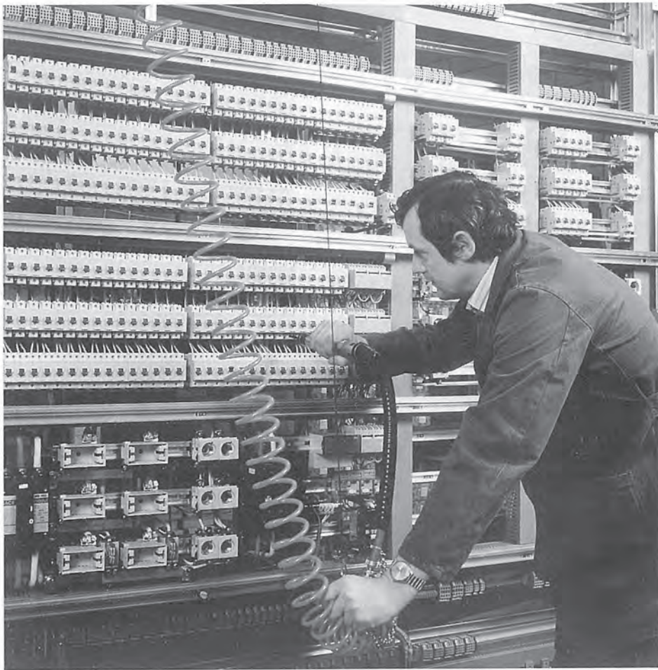
Sicherungsverteilung Industriebau, ausgeführt durch Jerzy Raszewski.
