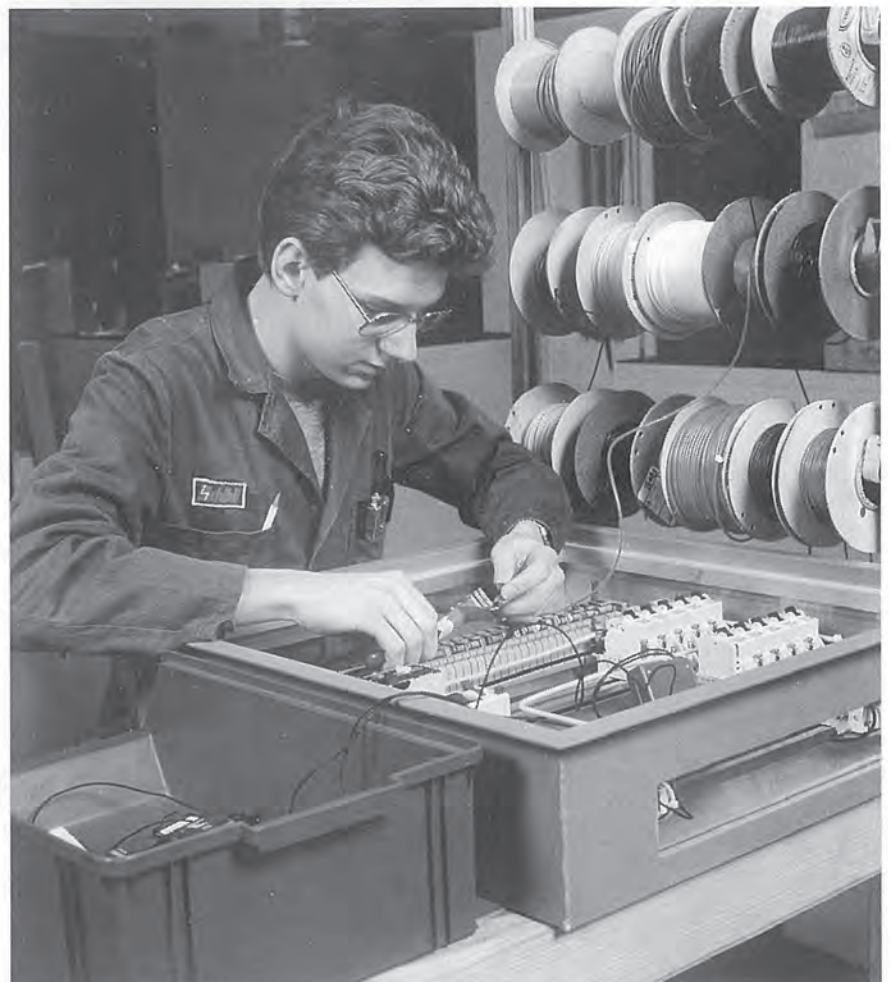
Einfache Verteilung im Wohnungsbau, ausgeführt durch Schaltanlagemonteur- Lehrling Thomas Schön.
