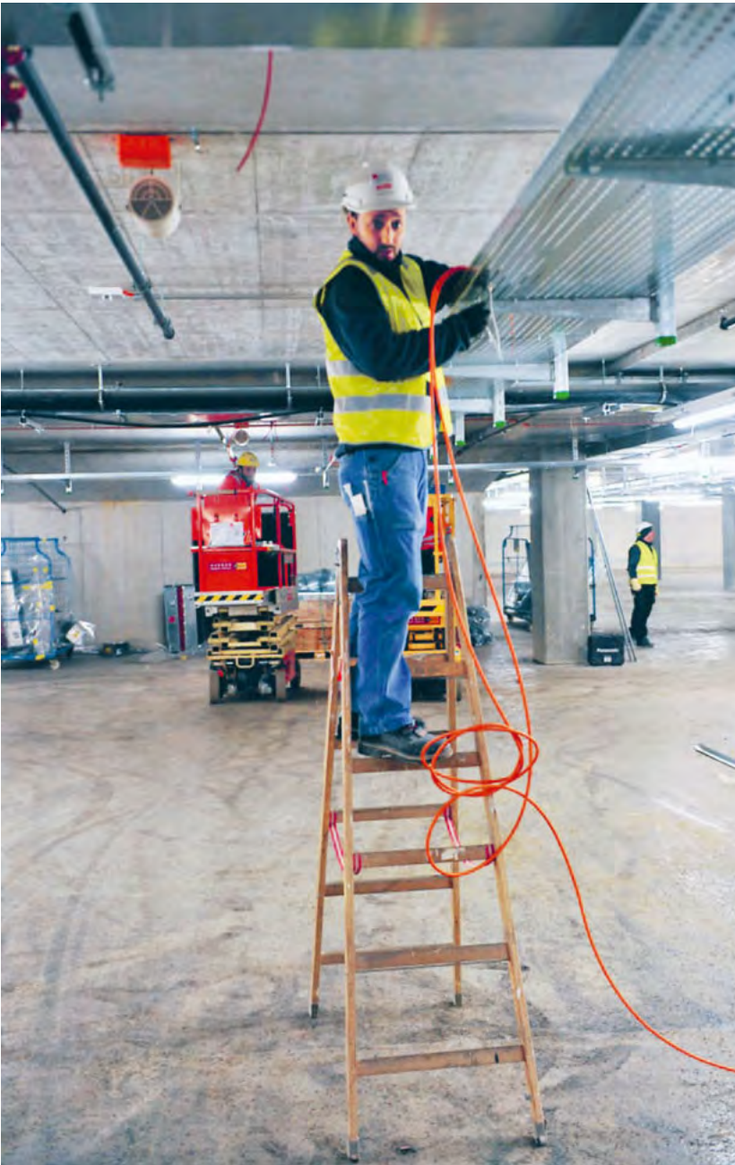
Grosse Räume und hohe Decke, die Arbeiten finden meist in der Höhe statt.
